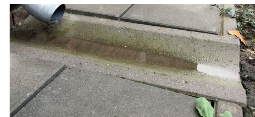
Gootjes van betontegels of keien voor de bovengrondse afvoer van hemelwater
